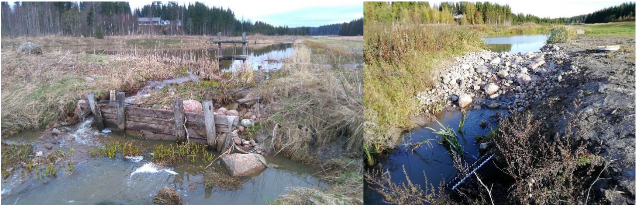
Kuva 2. Vasemmalla Pyyrylän kosteikon vanha, huonokuntoinen pato keväällä 2018 ja oikealla uusittu patorakenne. Koko kosteikon ilmakuva löytyy liiteraportin kannesta.
